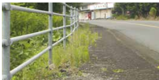
舗装の隙間から雑草が生えた歩道(唐隈)
