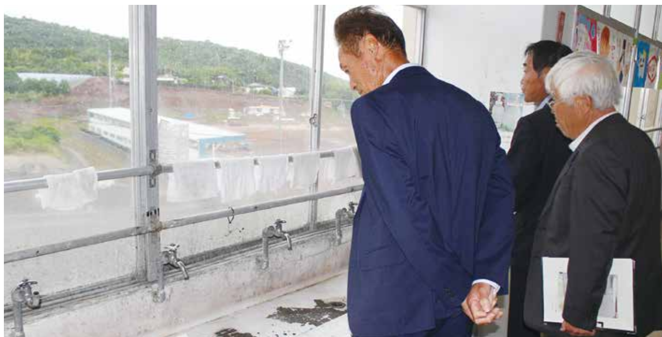
手洗い場の老朽化を確認
