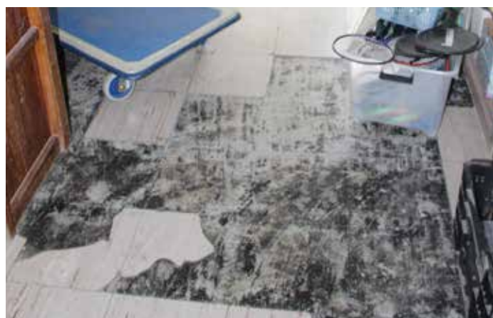
タイルの剥がれ(体育資料室)
