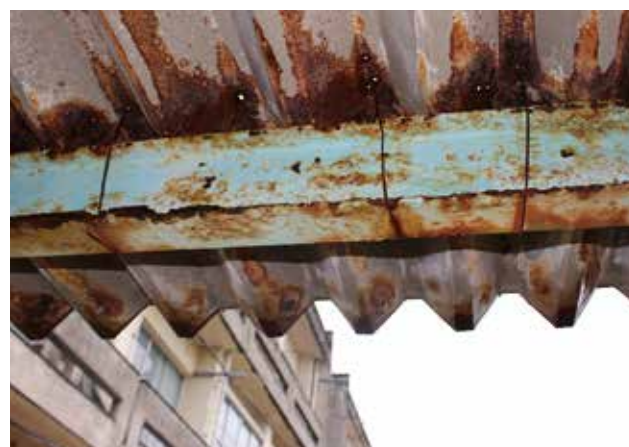
さびで変色し、腐食が進む屋根
