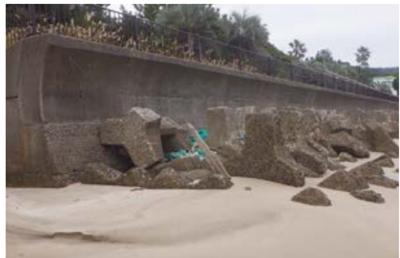
砂の堆積と消波ブロックの破損が進む小浜海岸
