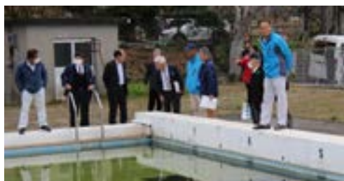
老朽化により藻が付着した町民プール
