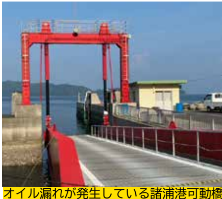
オイル漏れが発生している諸浦港可動橋
