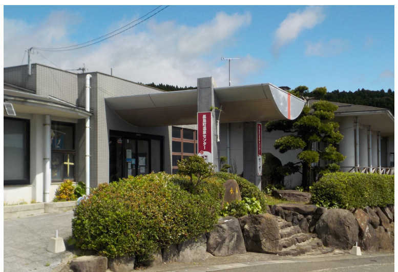
老朽化が進む温泉センター椿の湯
