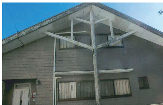
老朽化が進んでいるケビンの柱
