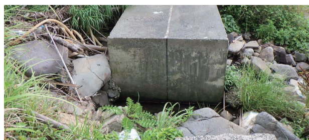
壊れたままの小浜遊歩道
