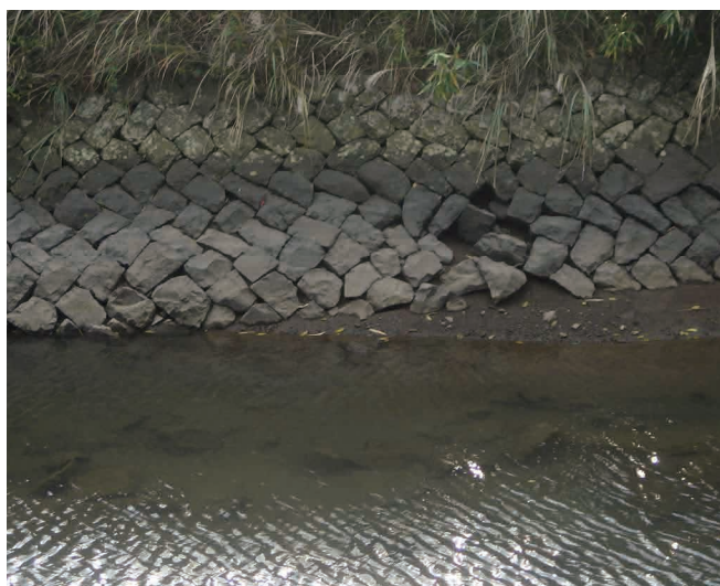
小浜川の崩れた石積み
