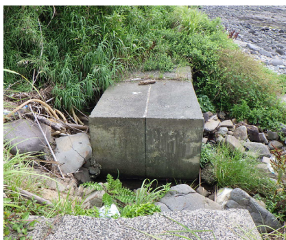
水害などで破損した路盤
