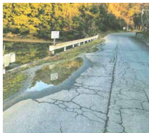
鹿大水産試験場前道路の冠水状況
