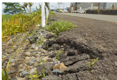
傷みがひどい国道沿いの歩道脇
