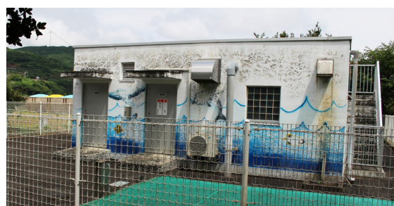
汐見潟地区漁業集落排水処理施設
