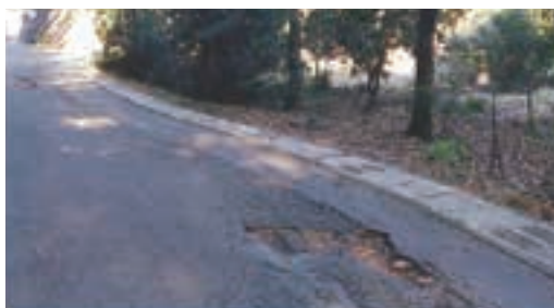
アスファルト舗装が傷んだ路面
