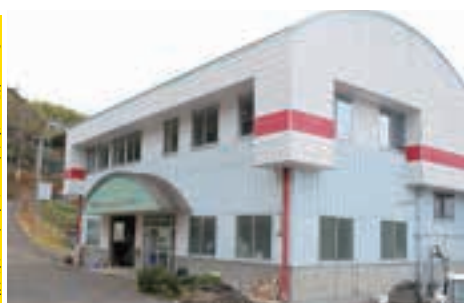
→指定管理後も多額の修繕 料が見込まれる
