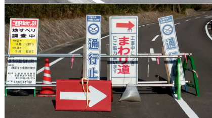
大型土のうで補強された県道葛輪瀬戸線（上）と通行止めを示す看板
