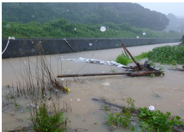
排水路が詰まり冠水した道路（浦底地区）
