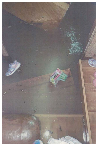
大雨で床上浸水した家屋内
