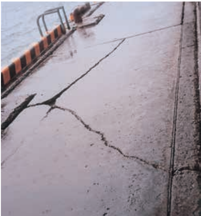
大きなひびが入った岸壁
