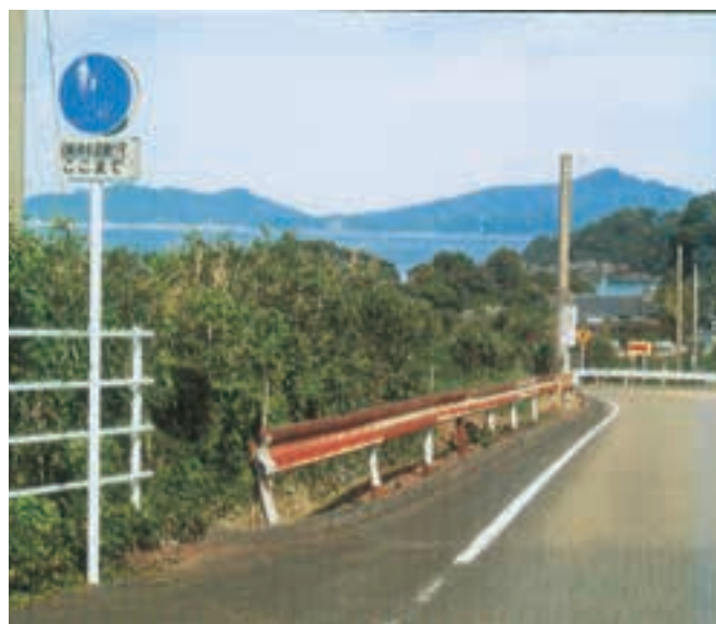
錆びたガードレール (指江地区)
