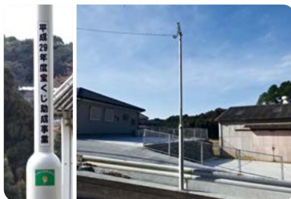
↑山中集落に整備された防犯灯
