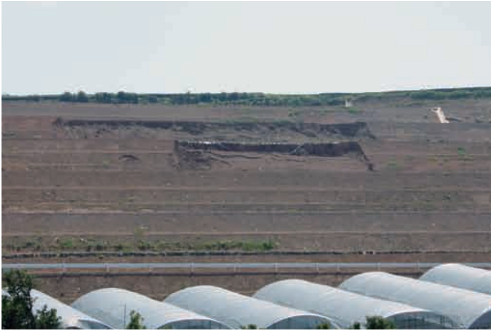
←斜面が崩れ落ちた基盤整備中の農地（平尾）
