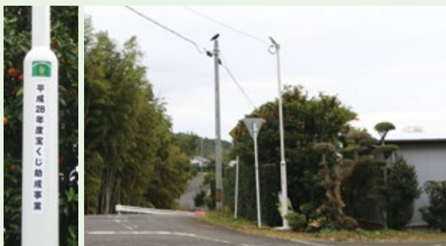
↑西集落に設置された防犯灯
