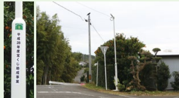
↑西集落に設置された防犯灯
