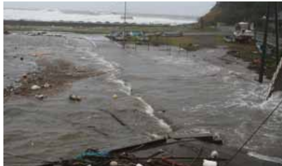
台風16号と大潮が重なり、浸水した唐隈港の護岸↓
