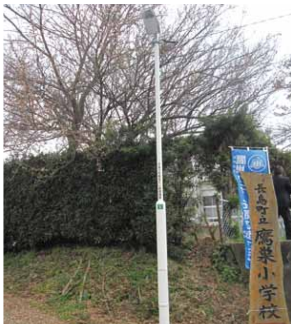
鷹巣小学校下に設置された防犯灯↑
