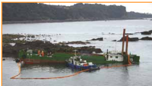
重油の抜き取り作業が行われた座礁した台船↑
