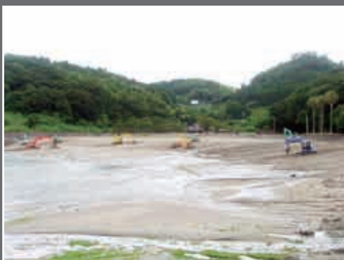
←海開きを前に、東建友会(福山義弘会長)は7月12日、ボランティアであづま海水浴場の整地作業を行いました。風雨で荒れていた海水浴場は、大型の重機で手際よく整備され、辺りは見違えるほどきれいになりました。
