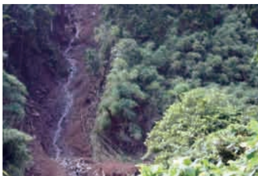
↑昨年、汐見地区で発生した土砂崩壊
