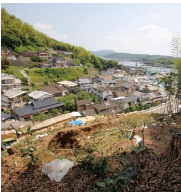
→地すべりが発生した薄井港線の法面
