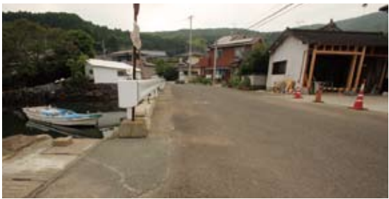
→外側線が消えてしまっている町道（田尻）
